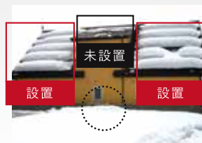
取り付けしていない部分の雪は 落ちています。
