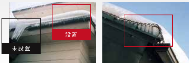
設置していない部分は ツララができています。
